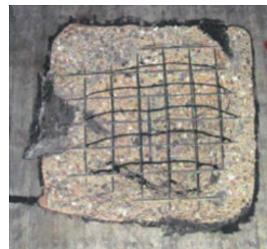
Bild 3: Beton C25/30, Zementgehalt 325 \text{ kg/m}^3 , W/Z-Wert 0,42, Luftporengehalt 1,5 %, PP-Fasergehalt 1,0 \text{ kg/m}^3 [15]
